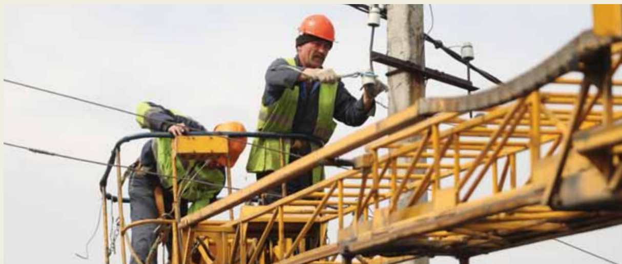
▲ Распределительная электрическая сеть 0,4 кВ на улице Антропшинская в городе Коммунар Гатчинского района построена еще 40 лет назад. Модернизация сетей была необходима для повышения качества электроснабжения потребителей.
